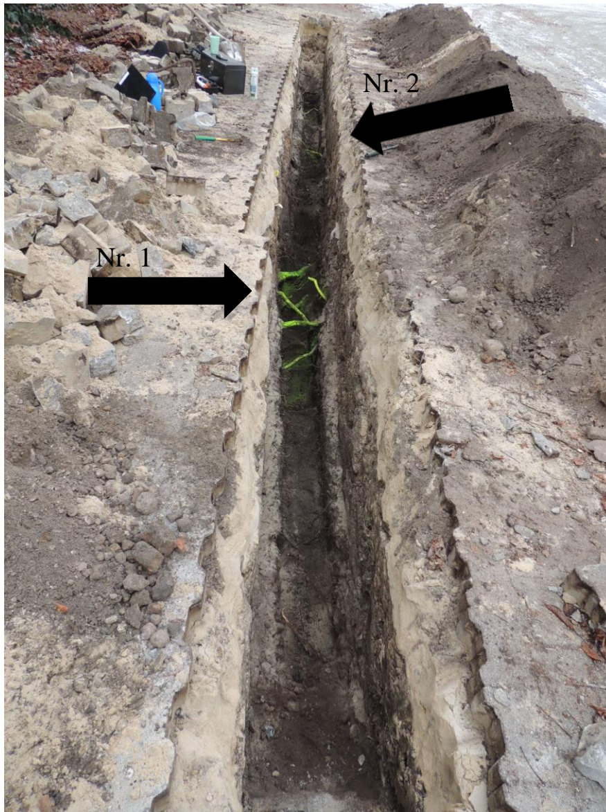
Abb. 1: Blick auf den 11 m langen Suchgraben; Pfeil Nr. 1 zeigt auf den stark durchwurzelteten Bereich; Pfeil Nr. 2 zeigt auf die beiden weiteren Wurzeln, die etwas außerhalb dieses Bereiches gefunden wurden
